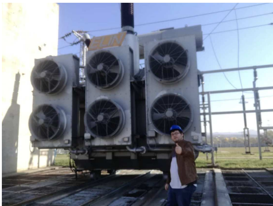
Obr.: Transformátor pre prevod zo 400kV na 220kV vedenie
